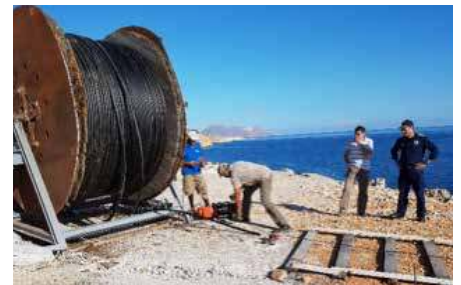
Kabeltrommel på land
